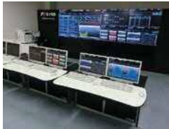
地域節電所内部の様子
