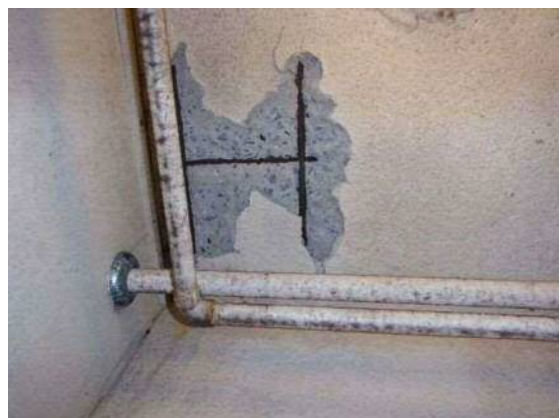
写真 1 コンクリートが落下した後の天井
