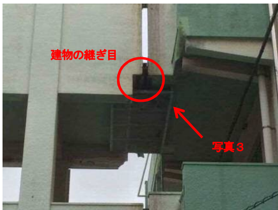
写真2 建物の継ぎ目
