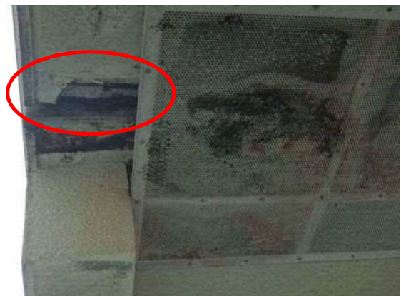
写真3 継ぎ目の劣化
