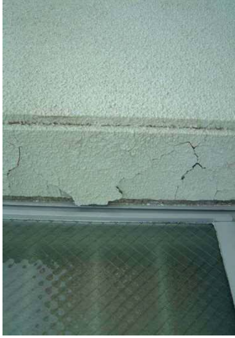
塗装仕上げ材の浮き・はく落
