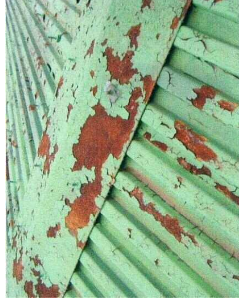
金属屋根の腐食
