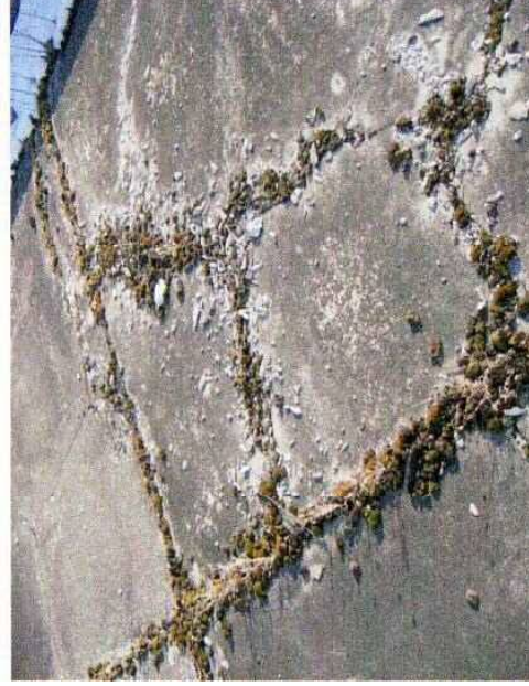
防水保護コンクリートの亀裂
