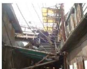
木造建物等の老朽化
