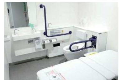
ユニバーサルシートが設置されたトイレ
