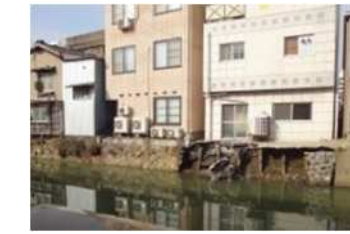
左岸護岸の崩壊(H26.3)
