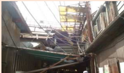
木造建物等の老朽化
