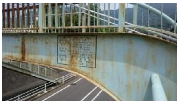
写真 3.2 修繕前の状況
