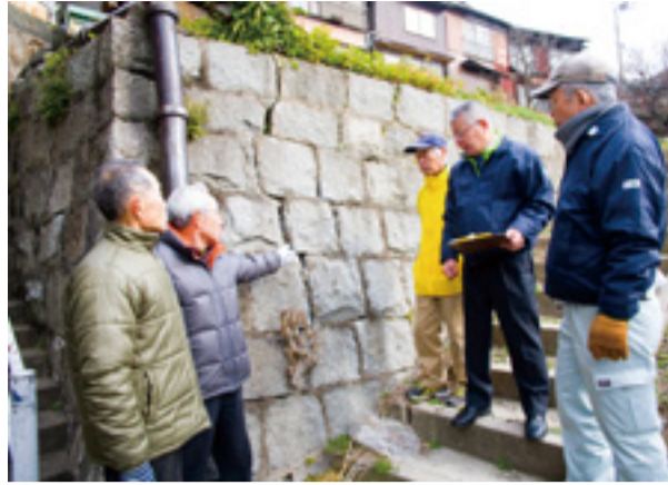
▲ひびの入った擁壁もチェック
