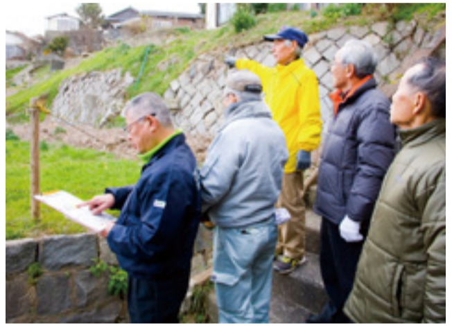
▲昨年7月の崖崩れ発生箇所
