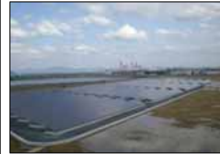
響灘太陽光発電所
