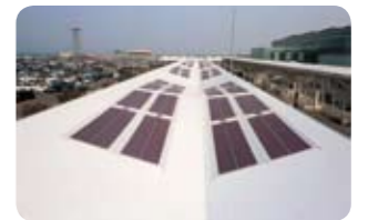
北九州空港の屋根に設置の薄膜太陽電池写真
