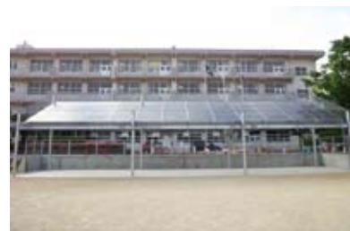
太陽光発電設備（出力10KWの設置例）
