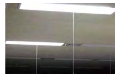
照明の間引きや引き紐スイッチの設置
