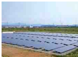
太陽光発電所
