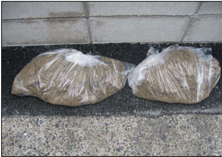
水道メーター保温材 (ビニール袋に砂等 を入れたもの)
