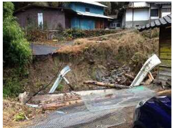
被災当時のうきは市・山口 3 号橋（市道山口線）
