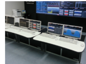
地域節電所内部の様子
