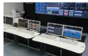
地域節電所内部の様子
