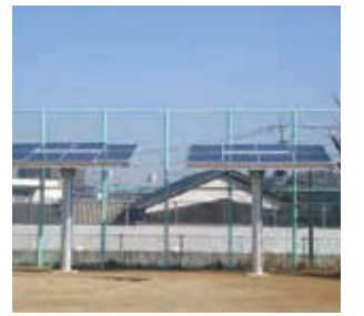
太陽光発電設備（出力3kWの設置例）
