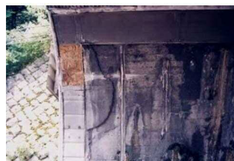
損傷事例(他団体管理のトンネル)
