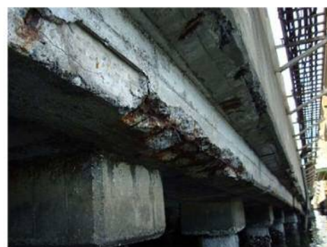
損傷事例(他団体管理の橋梁)
