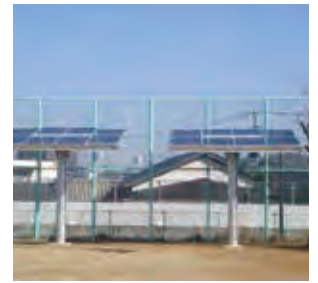
太陽光発電設備（出力3kWの設置例）
