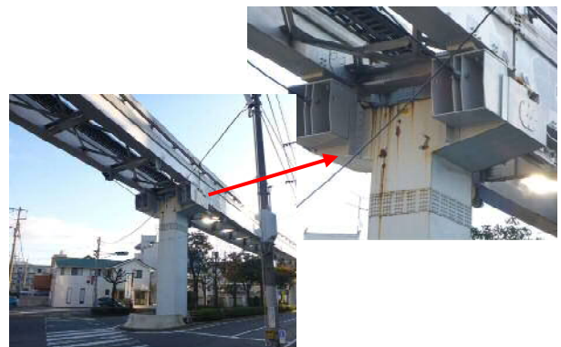
▲ モノレール・鋼製支柱の劣化状況
