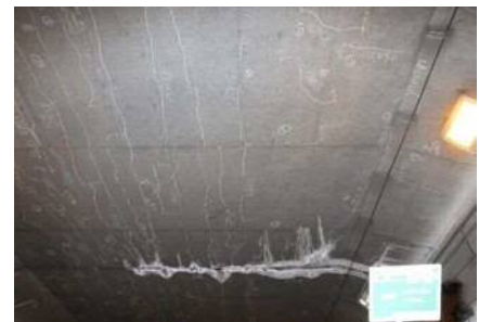
▲ トンネルのひび割れ状況
