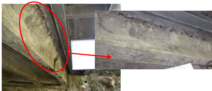
▲ 橋梁のひび割れ状況
