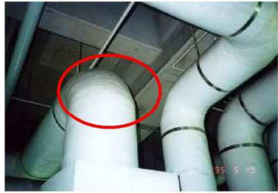
保温材（配管等）
