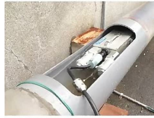
上下水管、プラント配管
