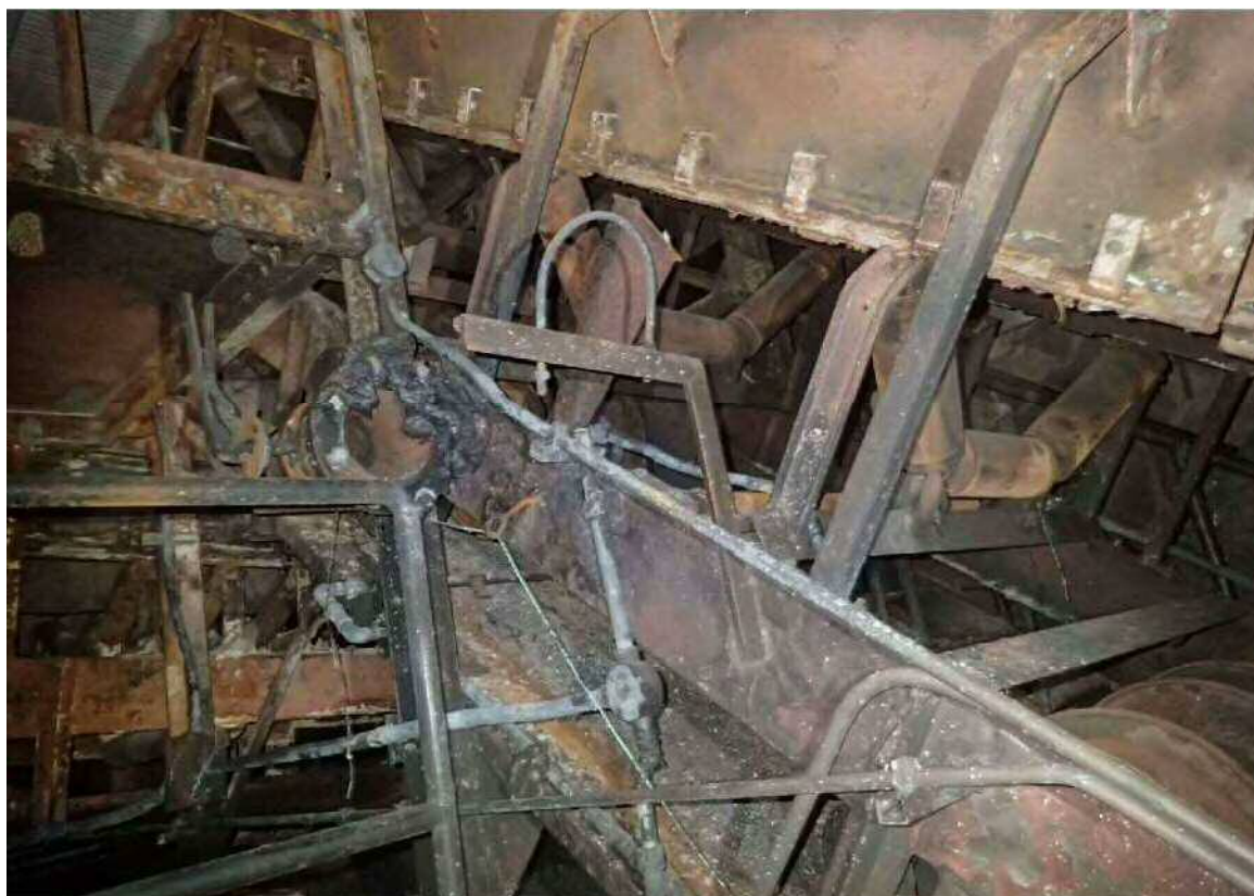
出火場所（破碎機から出た後のベルトコンベアー付近）
