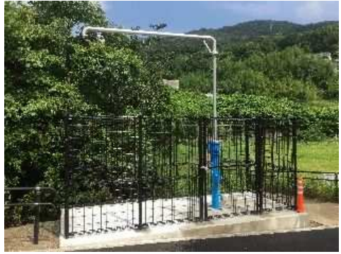
応急給水施設(給水塔)
