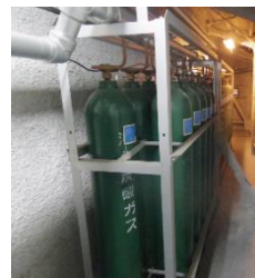
二酸化炭素貯蔵容器室
