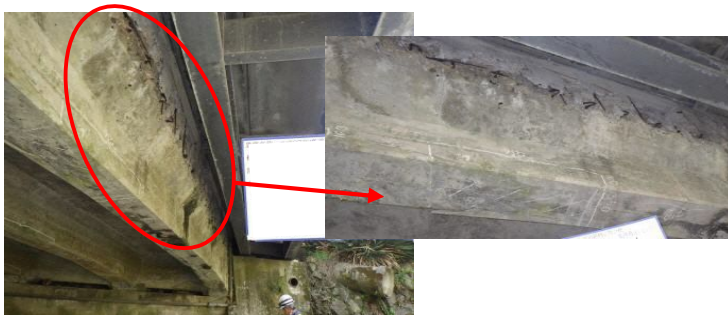
▲ 橋梁のひび割れ状況
