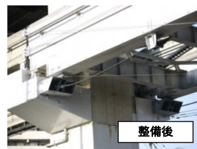
▲モノレールの耐震対策 （PCケーブルによる落橋防止）
