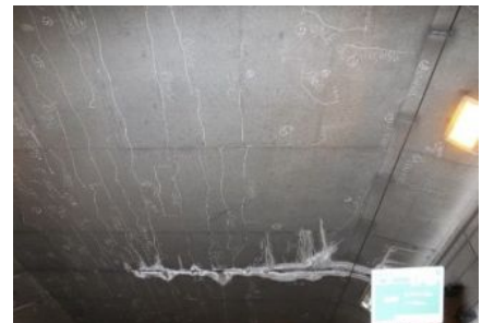
▲ トンネルのひび割れ状況
