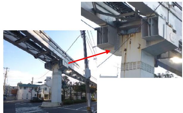
▲ モノレール・鋼製支柱の劣化状況
