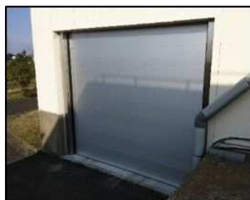
防水扉（防水シャッター）の整備状況
