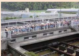
井手浦浄水場 ろ過池
