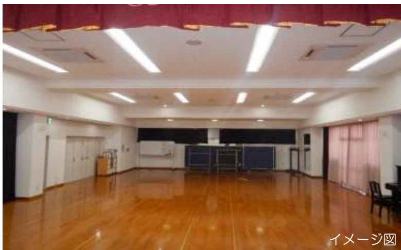
【照明のLED化や空調設備の改修】
