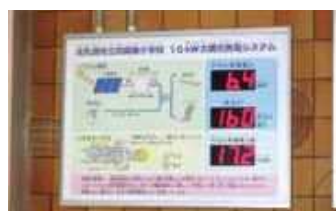
電力モニター
