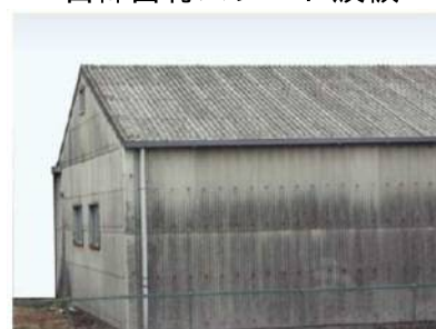
石綿含有スレート波板
