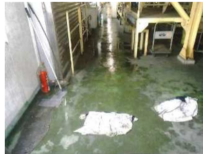
選別室内の雨漏り
