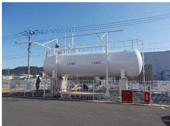
高圧ガス製造施設
