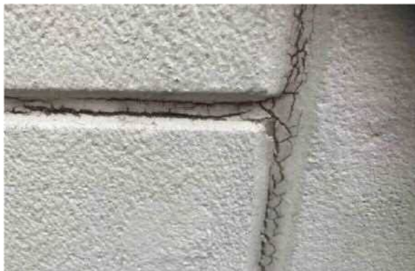
シーリング材の劣化（割れ）
