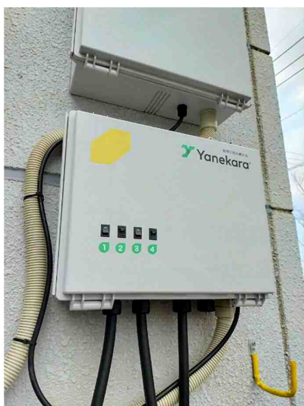
実証で利用する EV 充放電器
