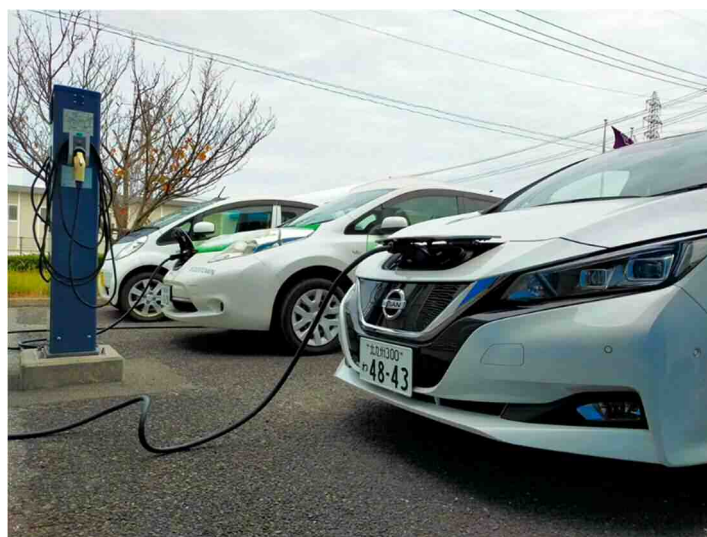
充放電器に接続した EV
