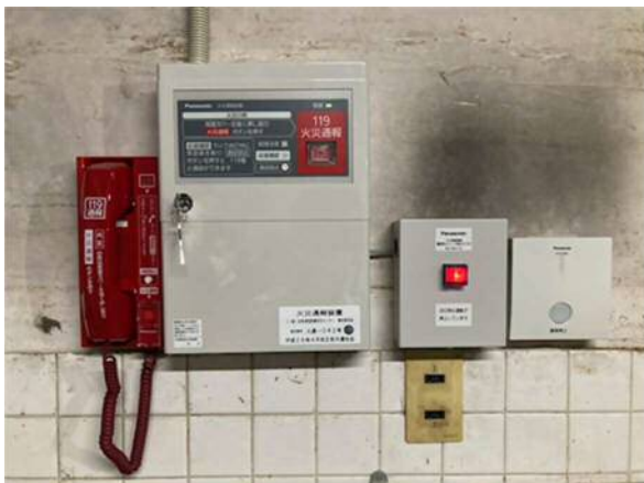
119番自動火災通報システム(本体)
