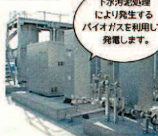
バイオマスエネルギーでの発電所
