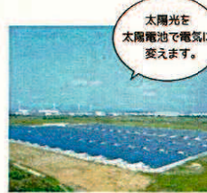
太陽光発電所
