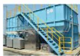
ハイフォン市に譲渡した排水処理設備
