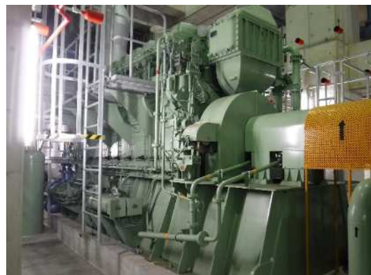
雨水ポンプ用エンジン
