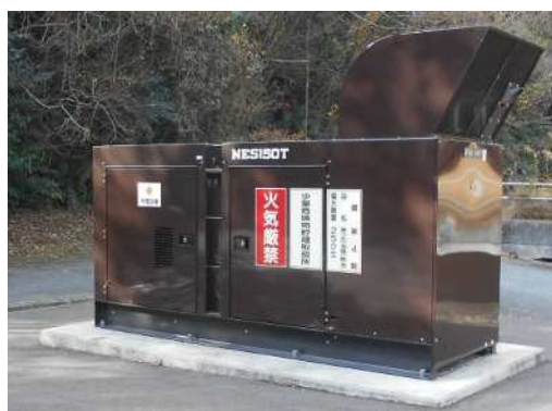
非常用発電設備
