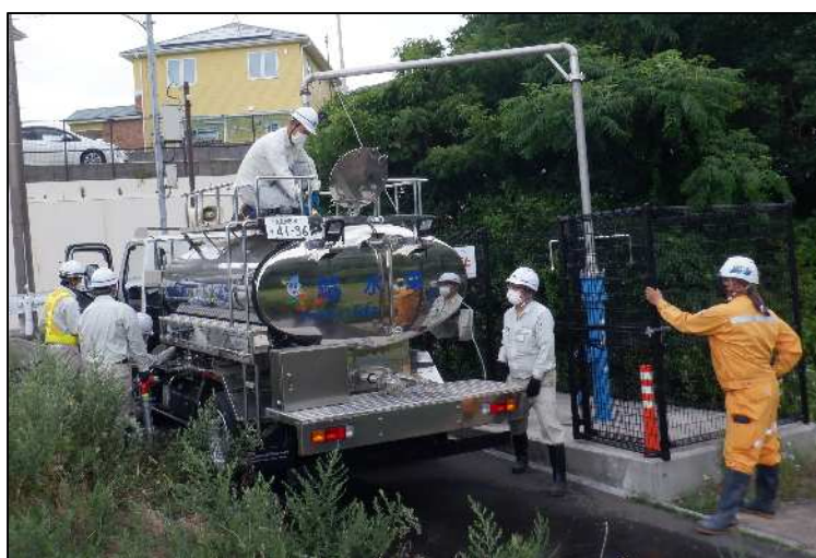
給水塔から給水車への補給状況
