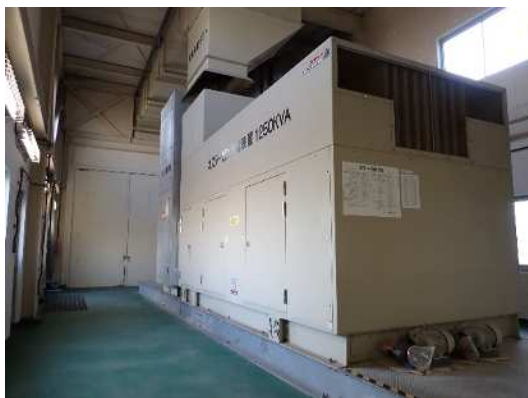
非常用発電設備
