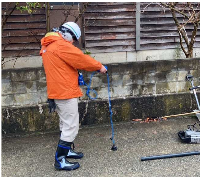
④漏水調査の状況 漏水音を確認する専用機器(漏水探知機)で 道路上から漏水調査(漏水箇所の特定)
