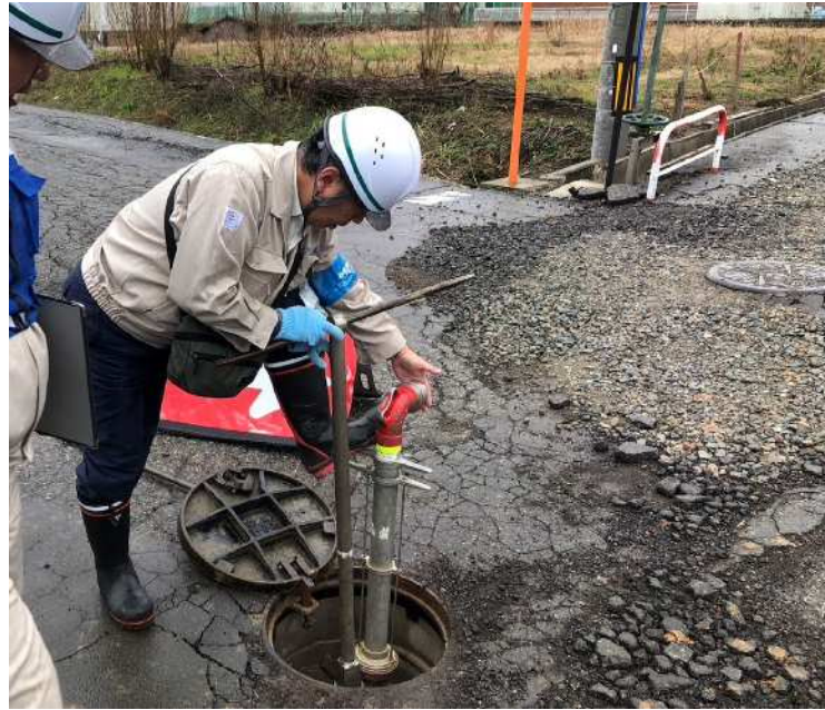
②水が出ない水道管の充水 バルブを操作することで管内に充水 ※漏水箇所の調査が可能
