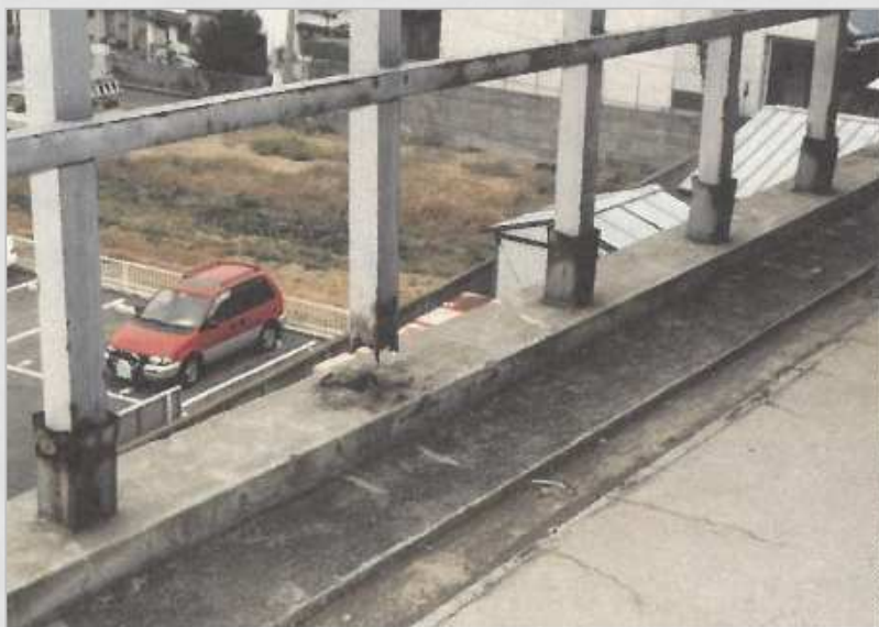
屋上手すりの支持部腐食
