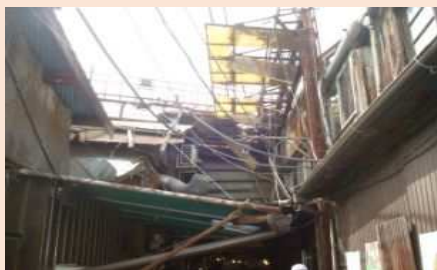
木造建物等の老朽化
