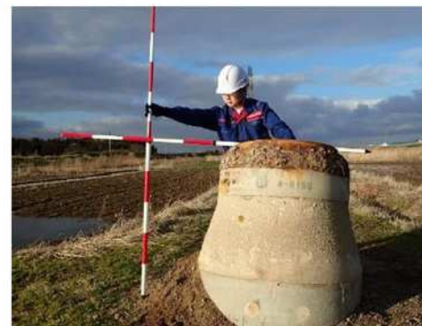
マンホール浮上現場（中能登町）
