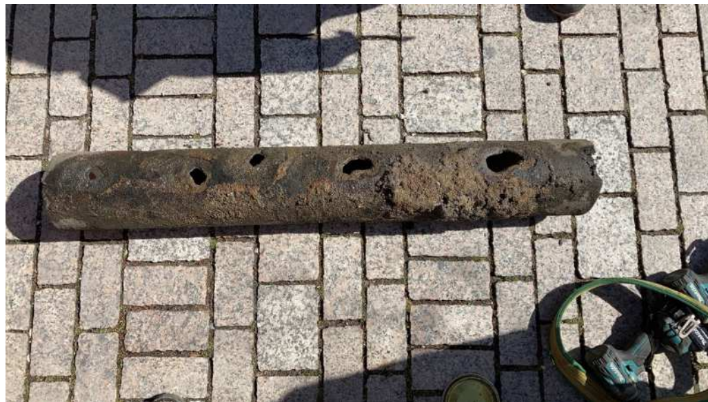
S53年に整備した水道管（配水管）
