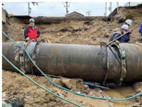
送水管の被害（七尾市）
