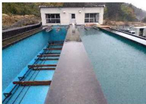
浄水場の被害（珠洲市）
