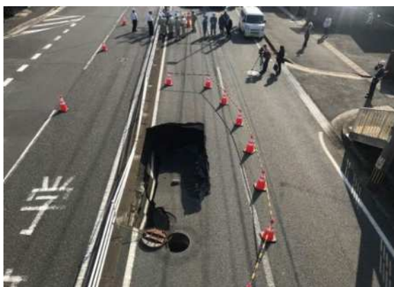
下水道管渠破損による道路陥没
