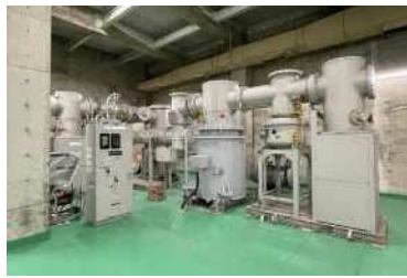
電力設備(変電設備)
