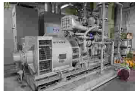
非常用発電装置
