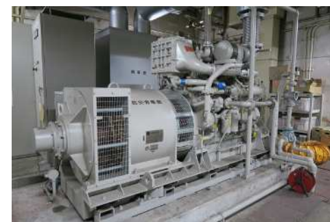
非常用発電装置
