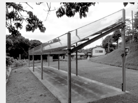
発電された電力は、校舎の照明電源などに利用しています。 (写真は最大発電電力10kWの太陽電池)
