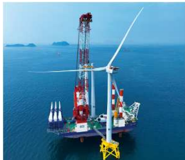
洋上風力発電関連事業
